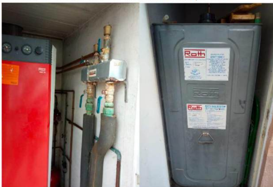
Fig. Caldera y depósito gasóleo actual
