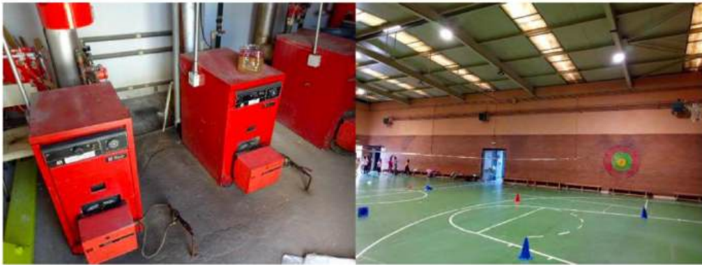
Fig. Sala Calderas y circuito de aerotermos cancha deportiva
